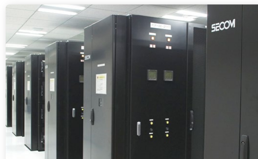
国内セキュアデータセンターの専用区域で個人番号を厳格に管理
